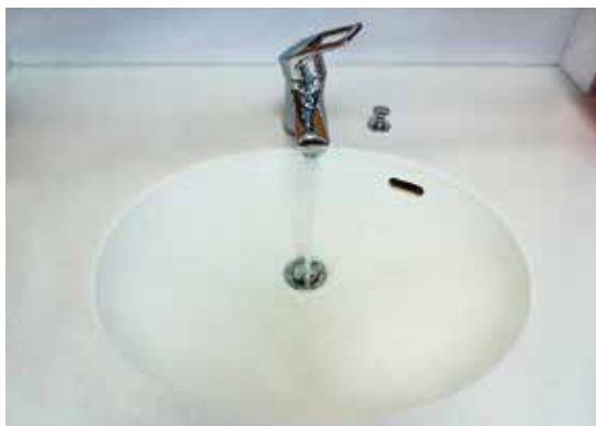
安全が確認された村の水道水
