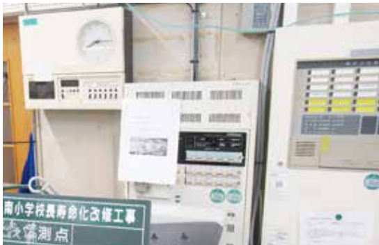
工事前の放送用設備
