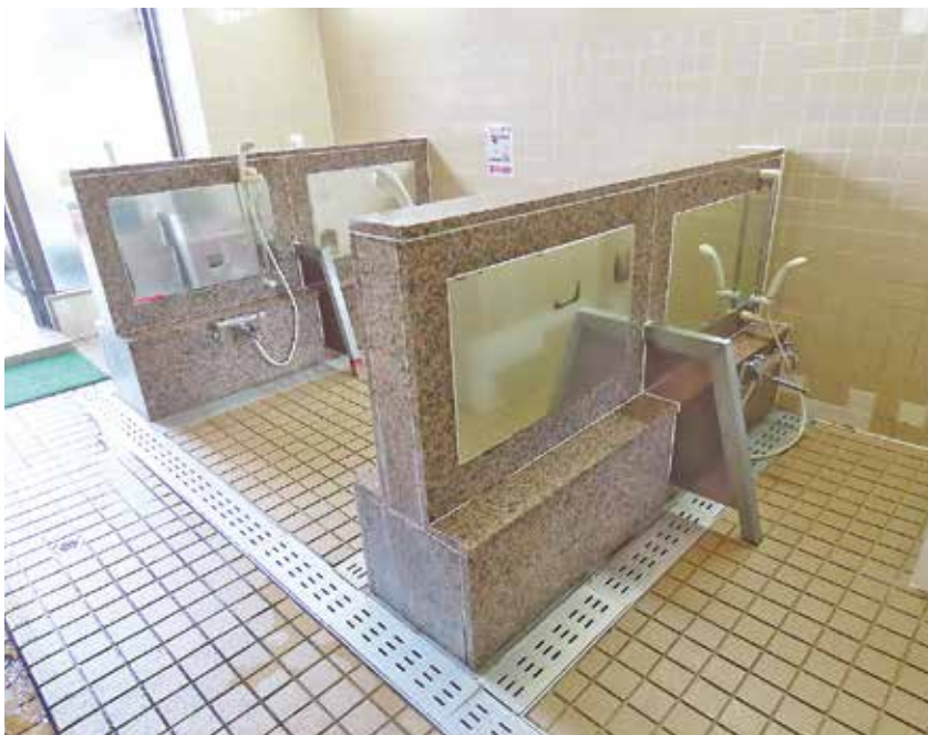
浴場シャワー設備
