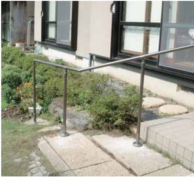
助成制度で設置した手すり
