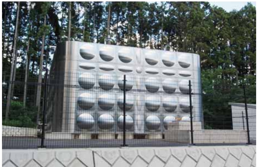
長岡にあるPC貯水タンク（飲料水）
