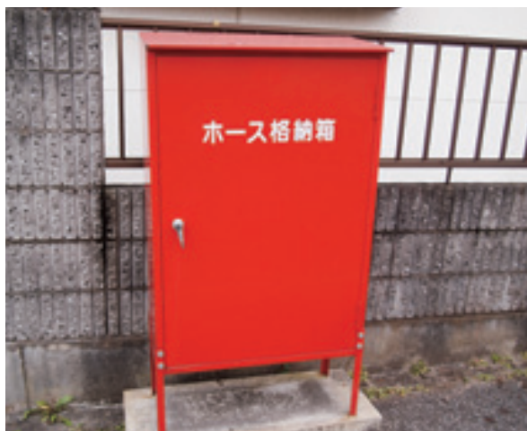
村内に設置の消火栓
